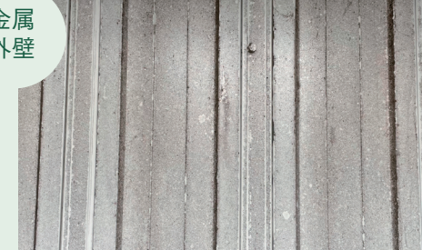
柱・外壁の全面にカビが発生
