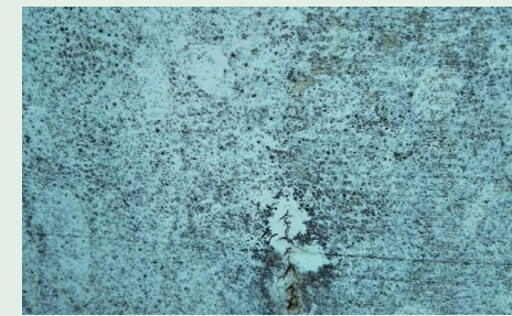
外壁の全面にカビが発生
