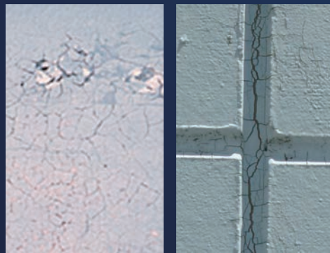
可塑剤が気化し、弾性を失った塗膜・シーリング
