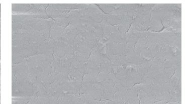
他社水性一液FRP防水専用塗料 塗膜表面に多数のひび割れが発生
